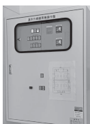
操作盤。館内温度など全体の状況を一目で把握
